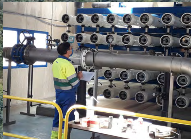
Operario de la ETAP El Girasol revisa la instrumentación de los bastidores de ósmosis inversa.
